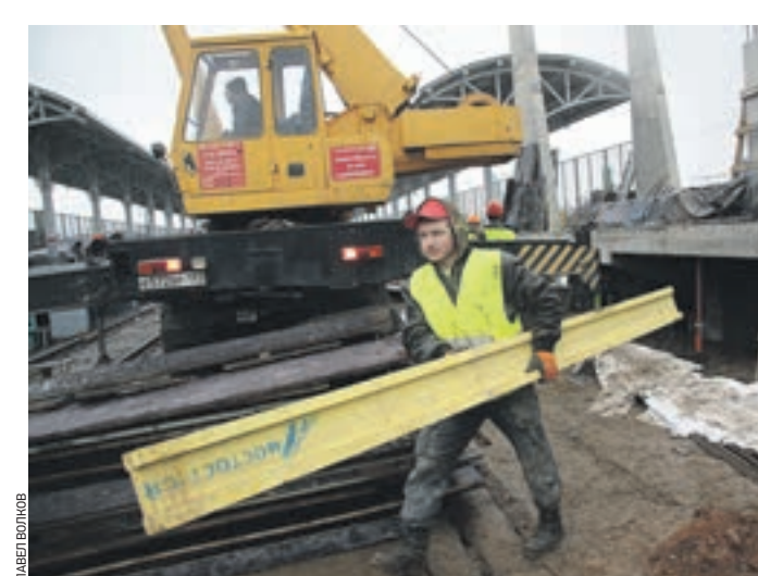
12 марта, стройплощадка станции «Черкизово» 11:26 Строитель Михаил Демчишин переносит балку на основе будущего перехода
