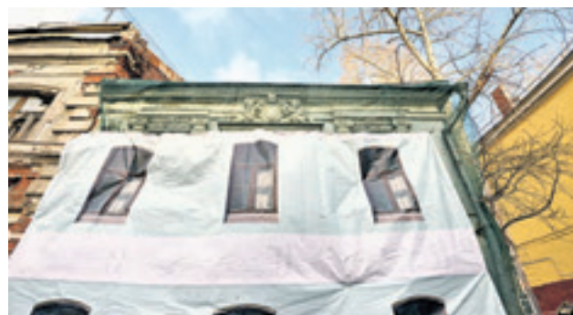
Вчера 13.45 Дом в Печатниковом переулке на грани обрушения
