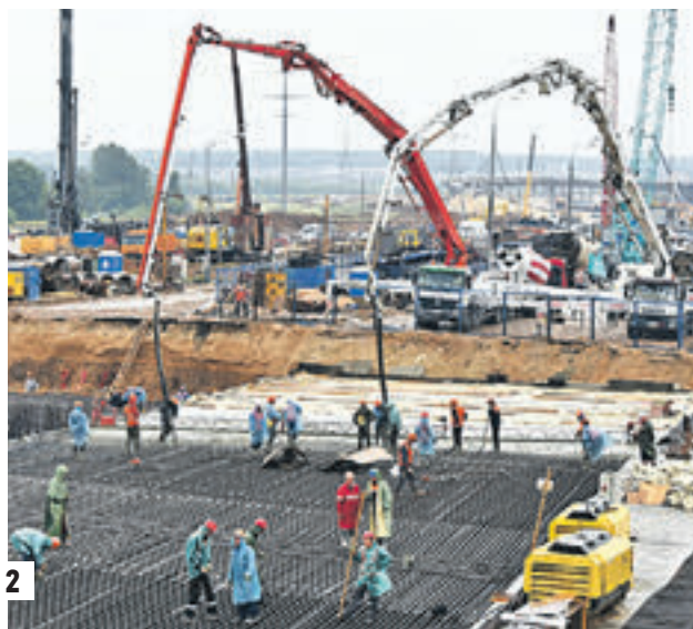
14 июля 2016 года. Мэр Москвы Сергей Собянин (слева) осмотрел ход работ по комплексной застройке территории ЗИЛа (1). 18 июля 2016 года. Строительство новой трассы Солнцево — Бутово — Видное (2)
