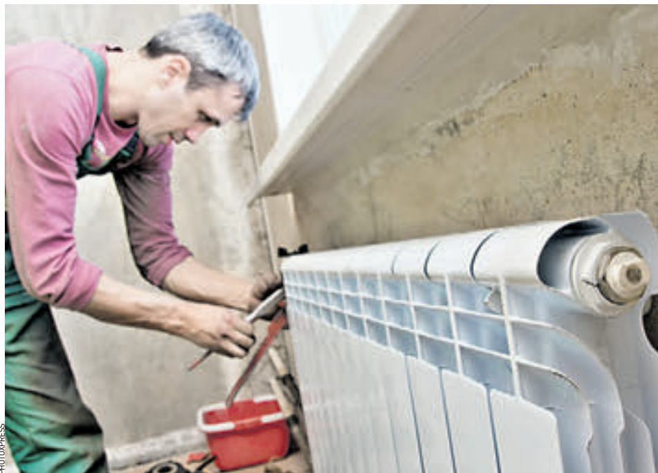
В наших домах единая сеть отопления. Если перекрыть ее хоть где-нибудь, все квартиры замерзнут
