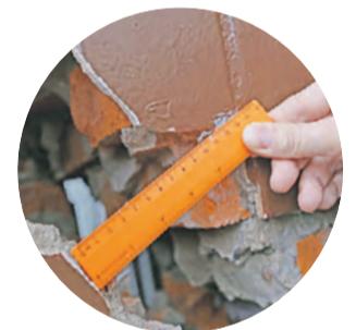
29 января 2015 года. Трещина в стене дома № 9 по улице Марксистской
