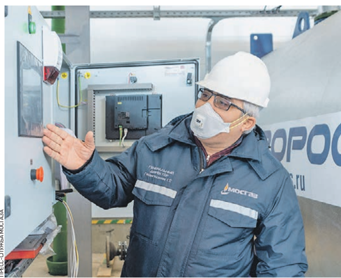
11 апреля 10:07 Генеральный директор АО «Мосгаз» Гасан Гасангаджиев проверяет оборудование для дистанционного управления котлами
