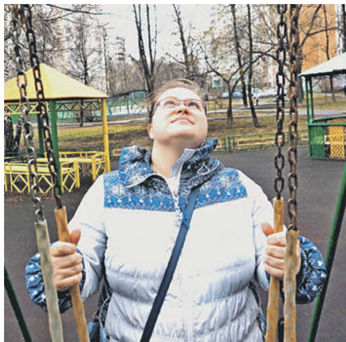
8 апреля 14:30 Вера Каширина показывает ржавые крепления качелей во дворе дома № 3 на улице Тихомирова
