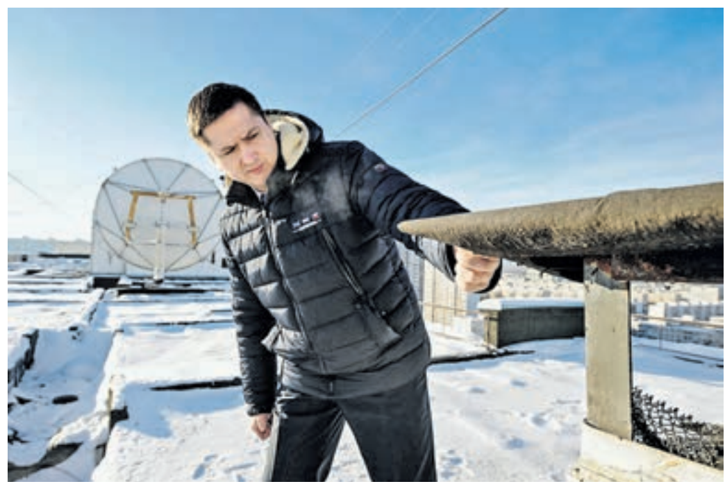
28 января 11:45 Глава управы Северное Чертаново Александр Демин осматривает козырек на крыше жилого дома
