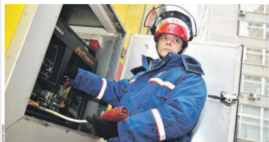
21 октября 11:00 Электромонтер Владимир Максимов готовится подключить кабель переносного генератора. Такие устройства стоят в каждом аварийном автомобиле МЭЗСК
