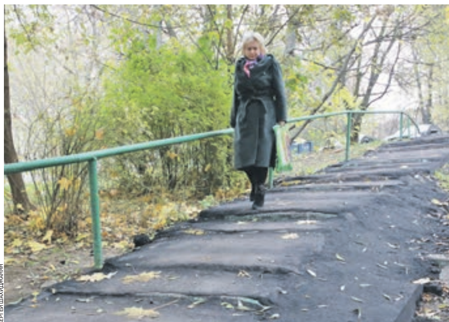
Вчера 12:30 Подъем, оборудованный ступеньками, ведущий к Чертановской улице, после косметического ремонта стал еще более неудобным, чем раньше
