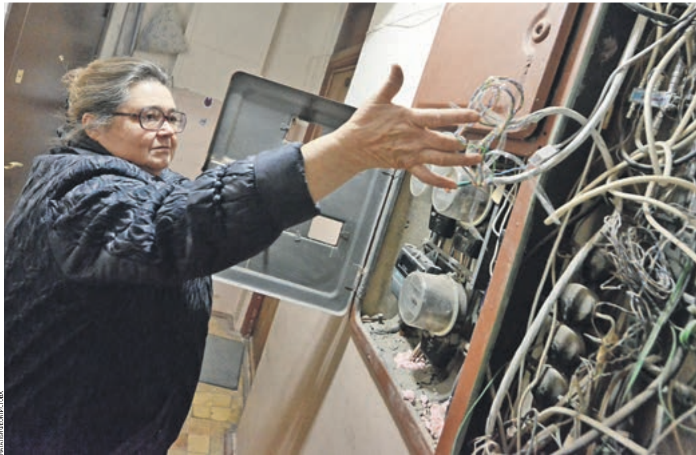
Вчера 13:00 Жительница дома № 61, корпус 2, по улице Трифоновской Анастасия Николаева показывает, как рабочие во время капитального ремонта некачественно подсоединили провода в щитке
