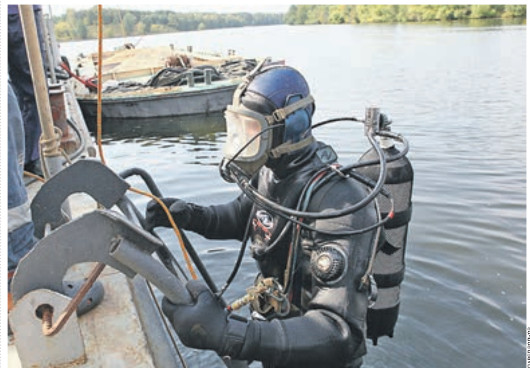
Вчера 11:08 Водолаз Олег Власов в районе Серебряного Бора обследует дно Москвы-реки, где пролегает газопровод. Его протяженность равна 138 метрам
