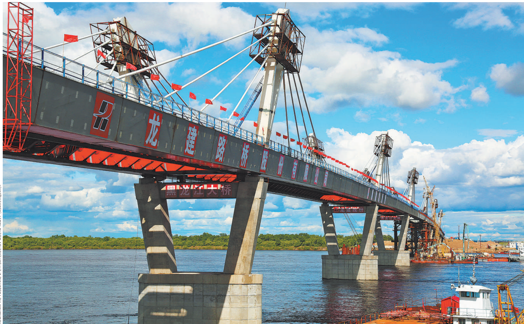
Элементы транграничного автомобильного моста Благовещенск—Хэйхэ были соединены 31 мая. Этот объект придаст новый импульс развитию торгово-экономических связей России и Китая и приграничных районов двух стран.
