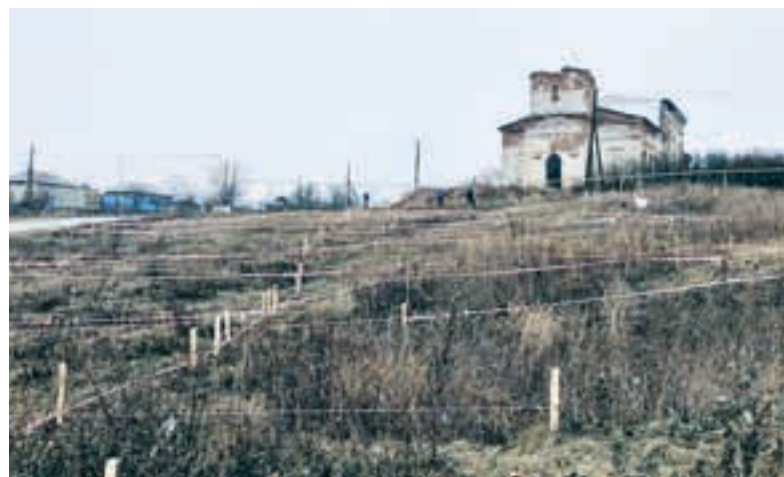
Храм Архангела Михаила в селе - здание величественное, даже несмотря на сегодняшнее плачевное состояние. Остается надеяться, что планы по реконструкции будут реализованы...
