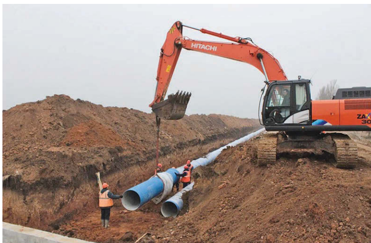
Срок службы такого трубопровода больше 50 лет.
