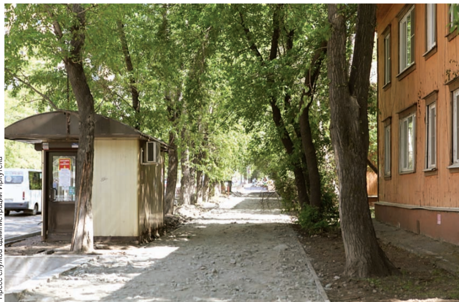
Работы на Депутатской продвигаются медленно. Деятельность подрядной организации приостановлена до устранения нарушений.
