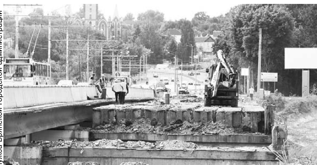
Старую часть Первомайского моста признали аварийной в апреле — там появилась дыра посреди дороги.
