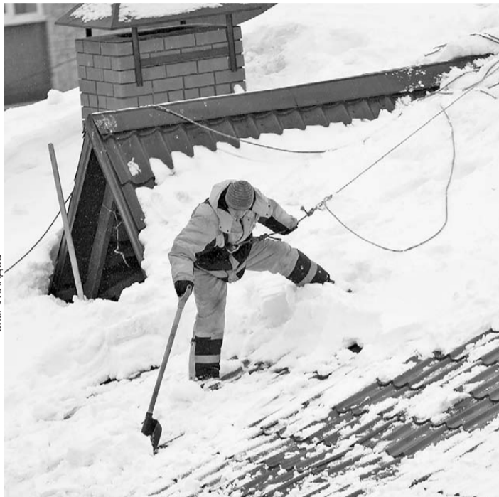
Стоимость уборки снега с крыши многоквартирного дома доходит до 40 тысяч рублей.
