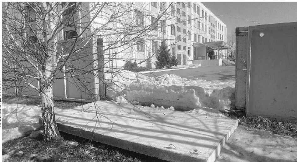
У бетонного забора школы № 31 прогнили сварочные швы, в результате чего он упал.
