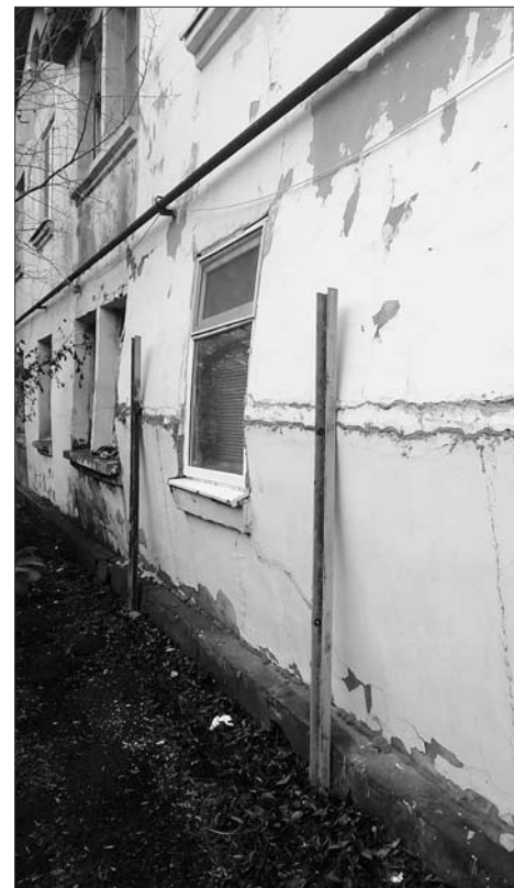
Шахтинцы живут в страхе, что их дом обвалится.
