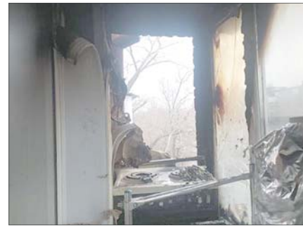
В многоэтажке вспыхнул пожар из-за загоревшейся на балконе плиты.
