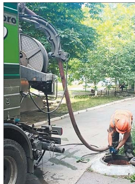
В Шахтах за две недели водоканал устранил около 600 коммунальных аварий.
