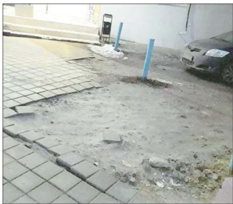
На улице Шевченко тротуар рядом с магазином — без плитки.
