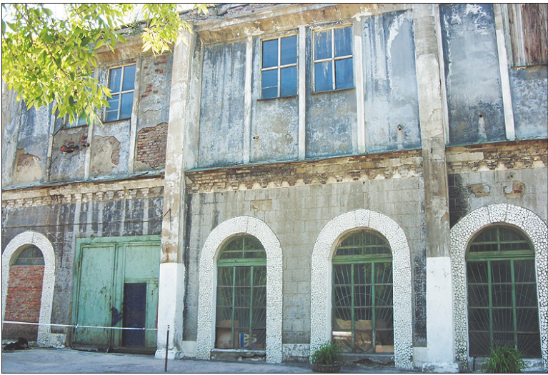
Здание котельной до сих пор работает. 2019 год.
