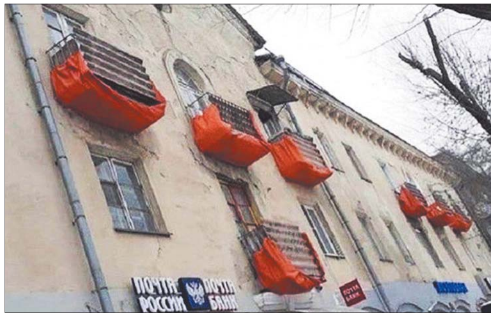
В Воронеже позаботились о безопасности горожан, натянув чехлы на разрушающиеся балконы.
