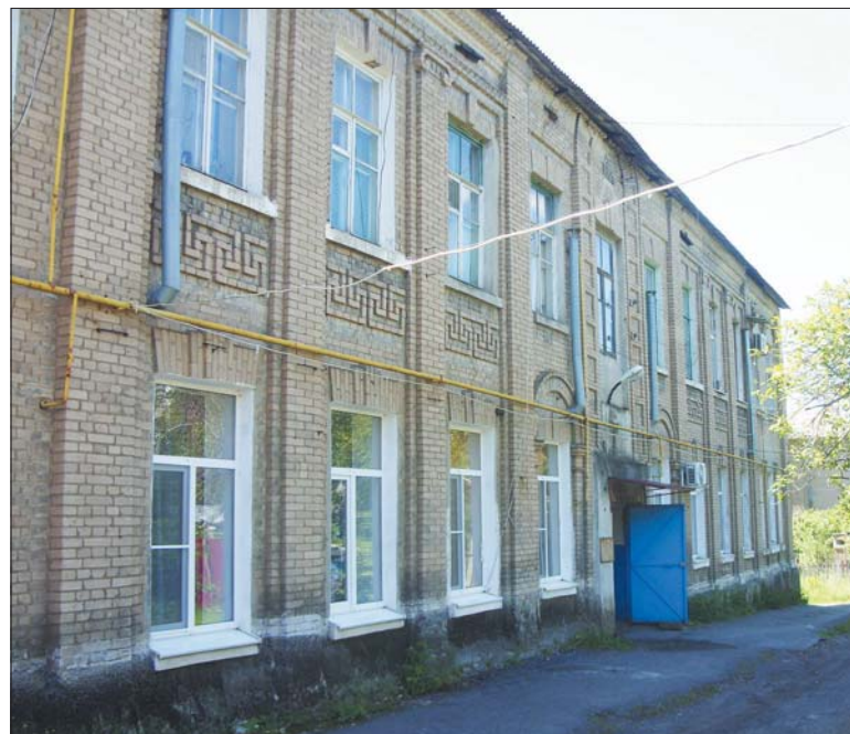
Двухэтажные дома из белого кирпича были построены 100 лет назад для инженеров шахты Елпидифор.
