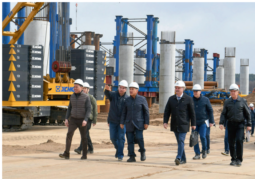
Осмотр раисом Республики Татарстан Рустамом Миннихановым хода строительства моста через реку Каму на автомобильной дороге М-7 «Волга».
