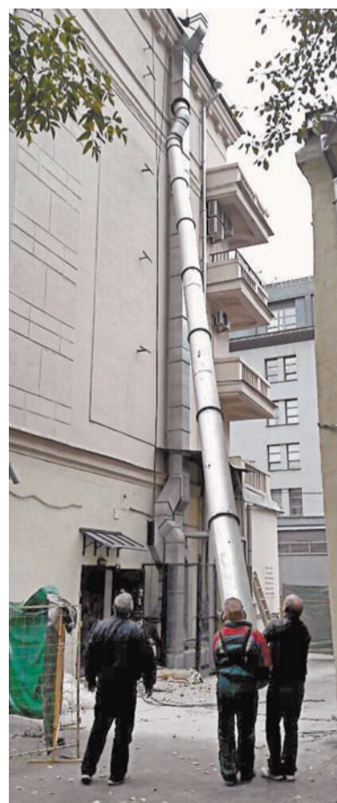
Незаконная вентиляция от кальянной (располагается в подвале дома в Б. Строченовском переулке).
